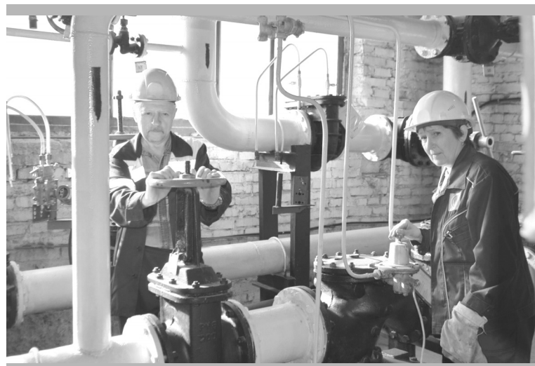
Специалисты цеха № 19 производят запуск газорегулирующей установки (ГРУ-2) на водогрейной котельной
