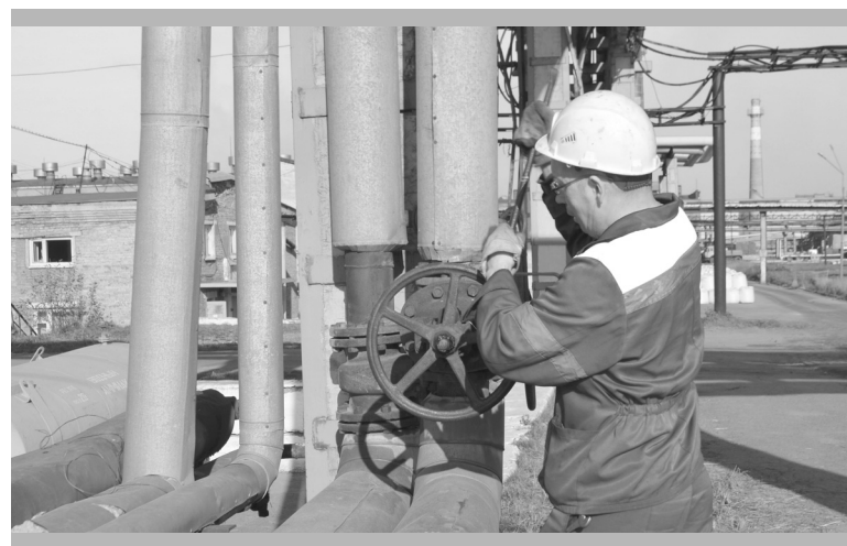
Дежурный слесарь Иван Паршаков на теплосети регулирует подачу теплоносителя в сторону цеха № 20
