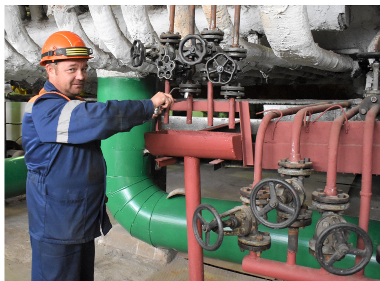
Слесарь по ремонту оборудования Александр Курганов: «Большое внимание уделили оборудованию водогрейной котельной».
