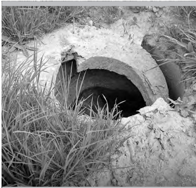
Колодец нуждается в срочном ремонте
